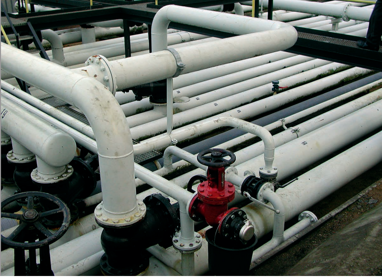
Rohrleitungen in einer petrochemischen Fabrik
